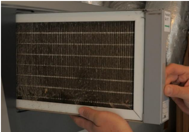
3. Filtermatten aus Lüftungsanlagen
